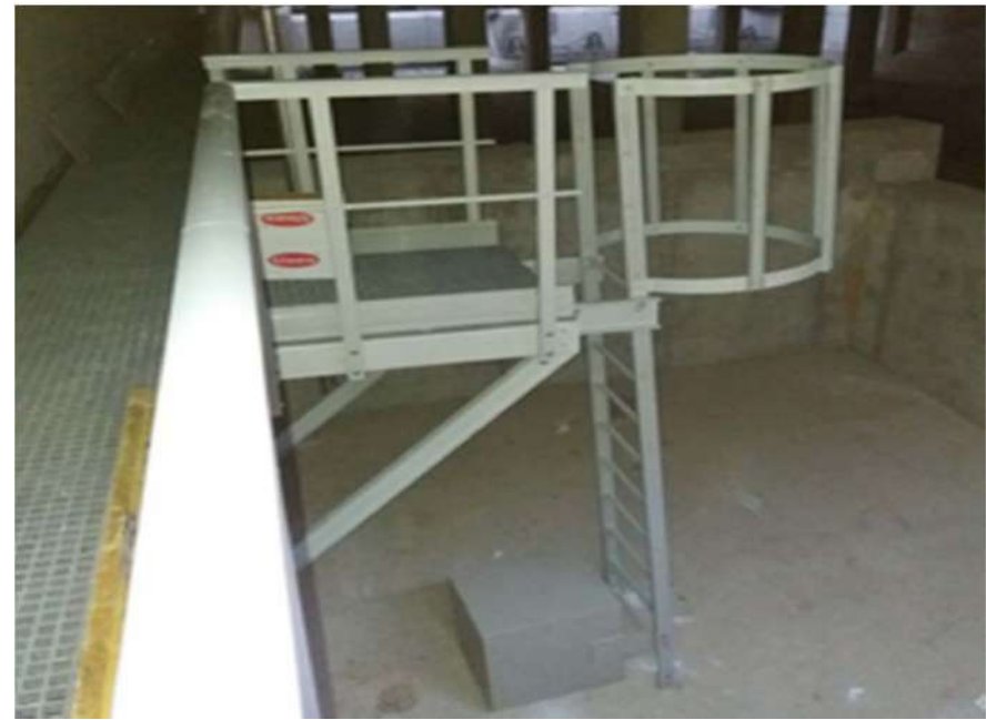
Escalera vertical con flotador
