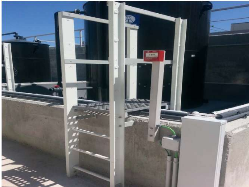
Escalera vertical sin crinolina
