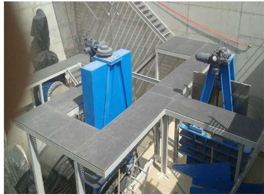
Plataforma PRFV en altura y pilares estructurales
