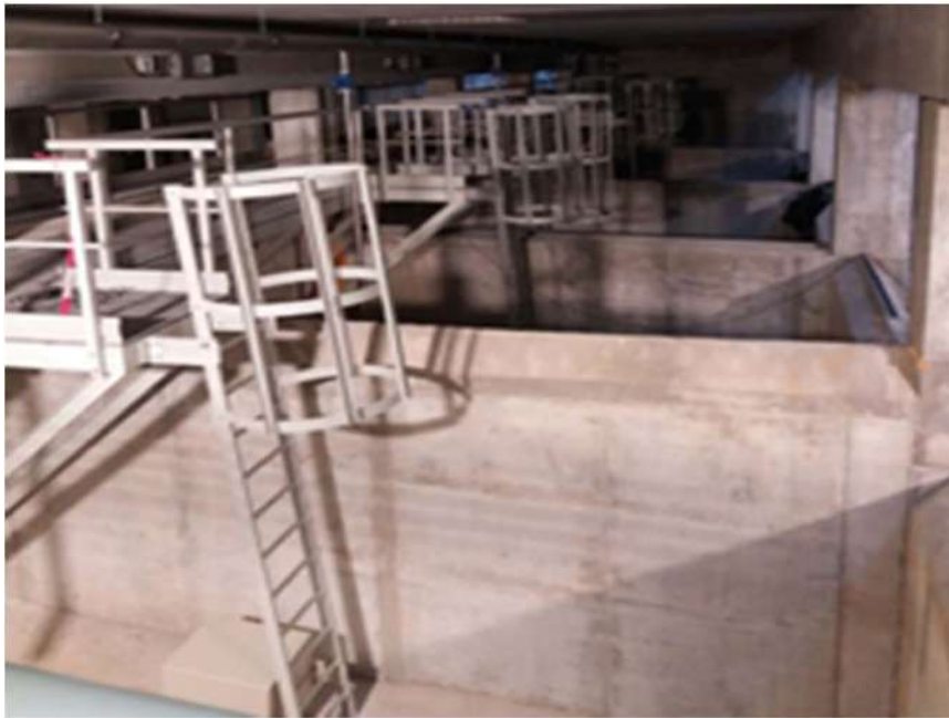
Escalera de seguridad con flotador
