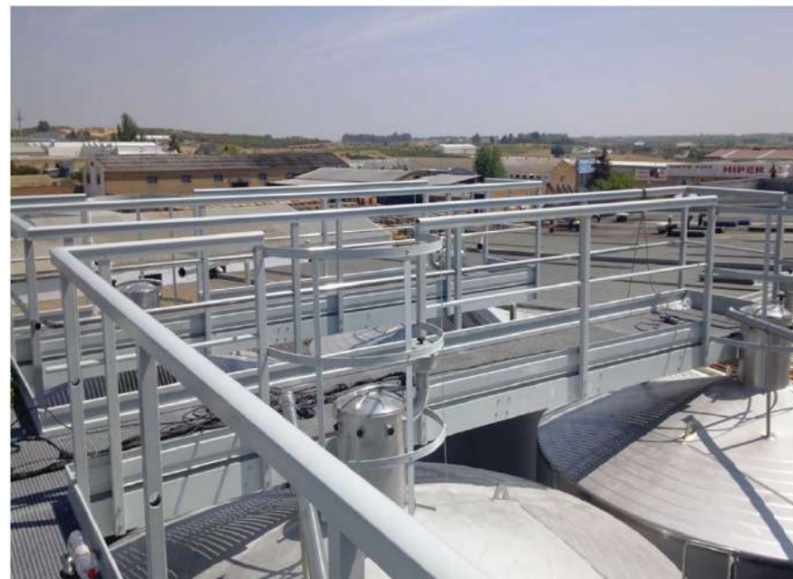
Pasarelas protegidas sobre depósitos con escaleras de gato
