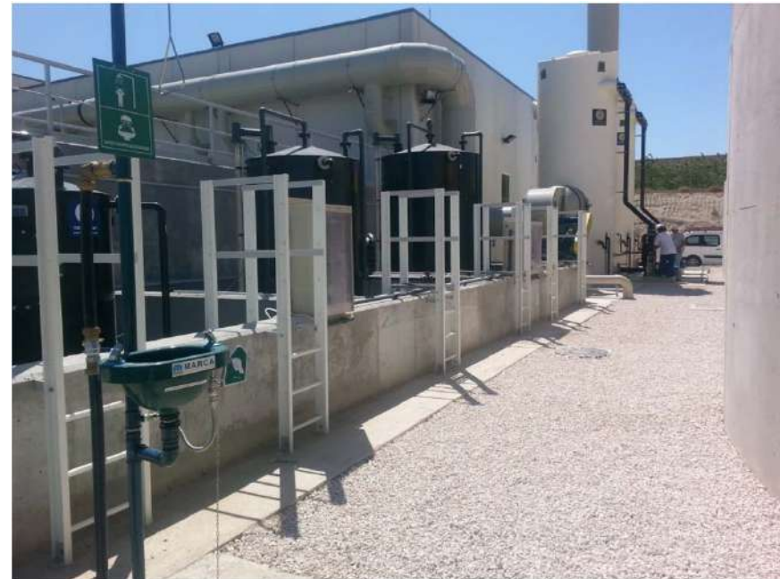
Escalera vertical sin crinolina
