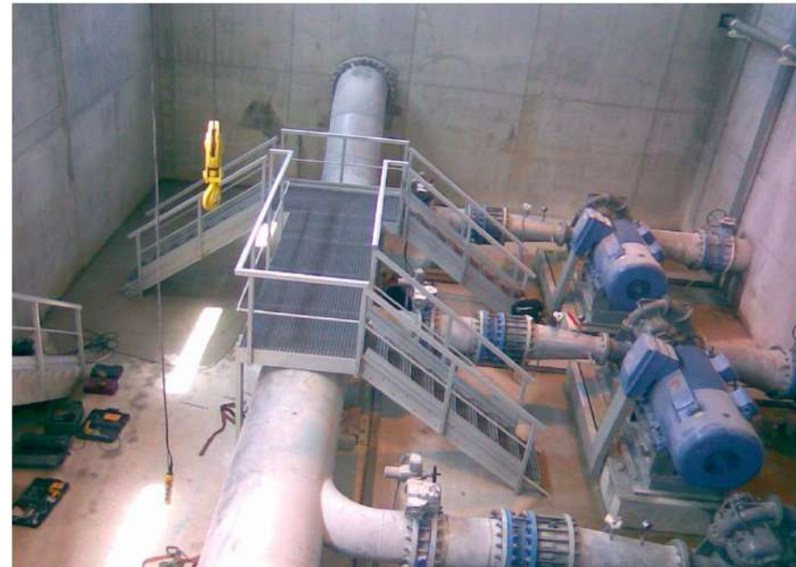
Bombeo Desaladora Alicante II. Noviembre 2008 Escaleras , barandilla y pasarelas
