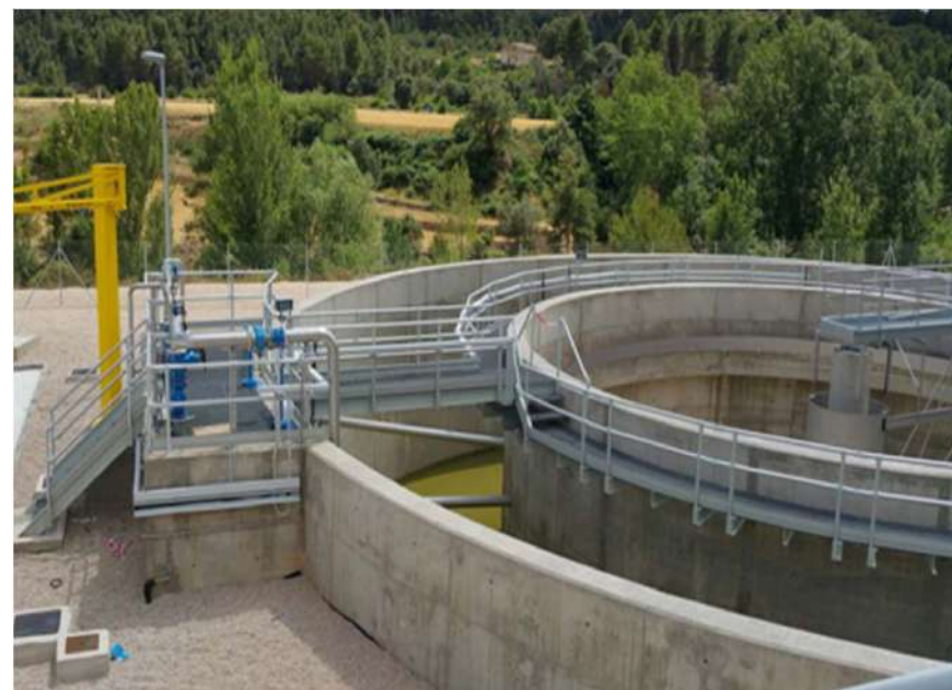
Sistema de pasarelas y plataformas acartabonadas con escaleras inclinadas y barandilla de protección perimetral ergonómica
