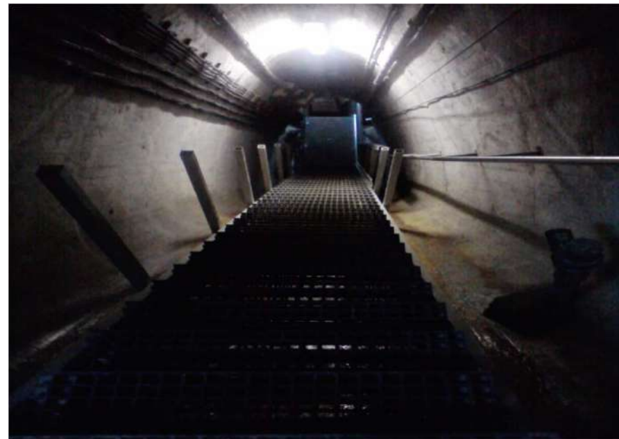
Escalera inclinada con barandilla de protección ergonómica
