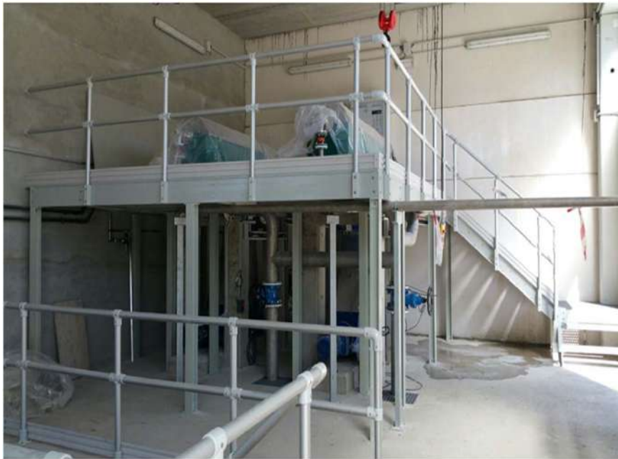
Plataforma PRFV en altura y pilares estructurales
